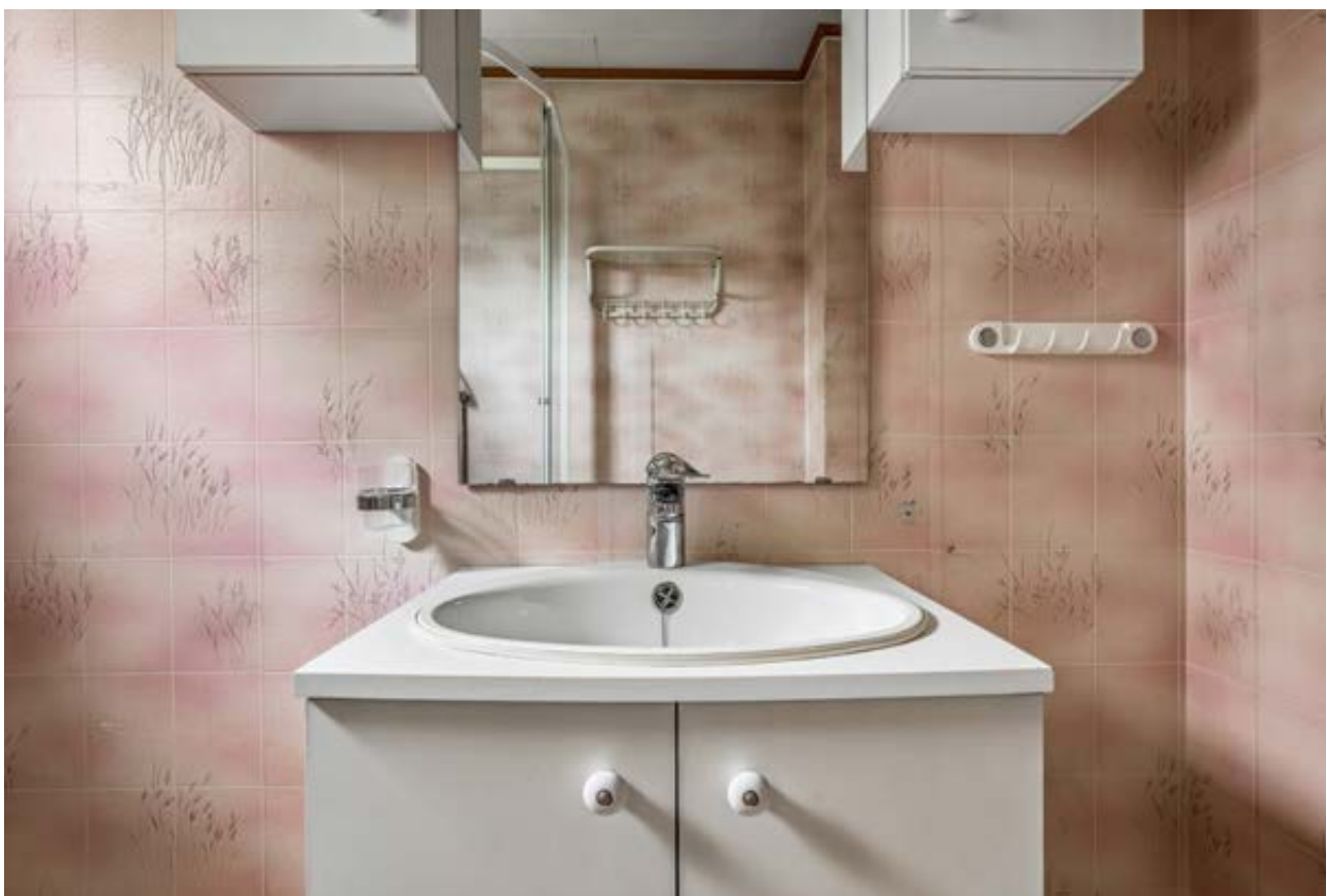
Vaskeservant m/innredning på baderommet
