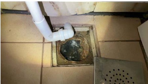
Sluk på bad
