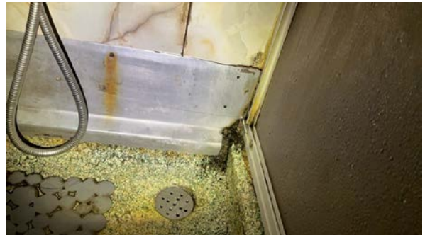
Råteskader i vegg
