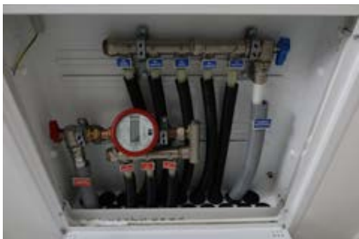
Fordelere for vannbåren gulvvarme.
