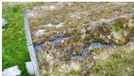
Oversikt. Torvtekking har forskyvet seg slik at torvtaksmembran er synlig.
