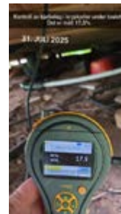
Kontroll av fuktnivå viser på befaringsdagen 17,5% under toalettrom.
