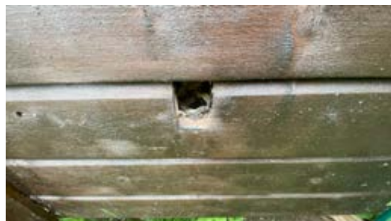
Åpning i vegg ved toalett. Må utbedres
