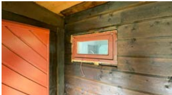
Mangler tetting og omramning rundt vindu på toalett
