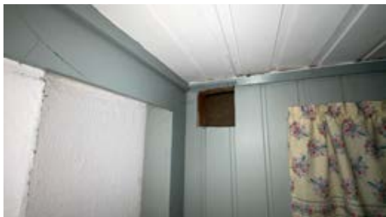
Tidligere ventil på vegg er kledd igjen. Bør etableres ny ventil
