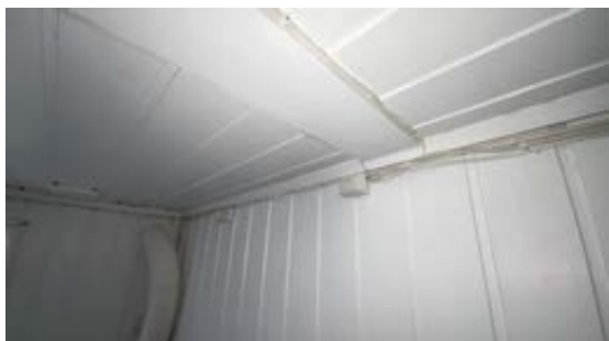
Mangle kabler er tatt ut fra samme koblingsboks på toalett. Synlig ufaglært arbeid.
