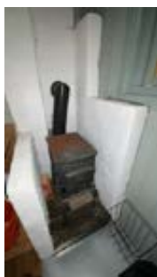
Overflaterust på vedovn inne på kjøkken
