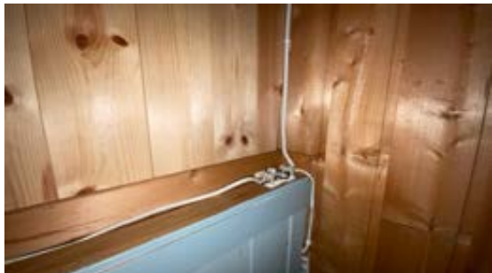
Åpen koblingsboks over inngangsdør, synlig fra hems
