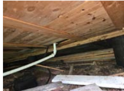
Mangler bord/tilstrekkelig tetting i bjelkelag ved rørgjennomføring
