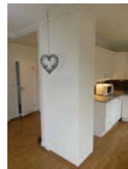
Pusset og malt pipe i leiligheten
