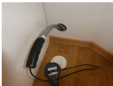
Fuktmåling i vegg
