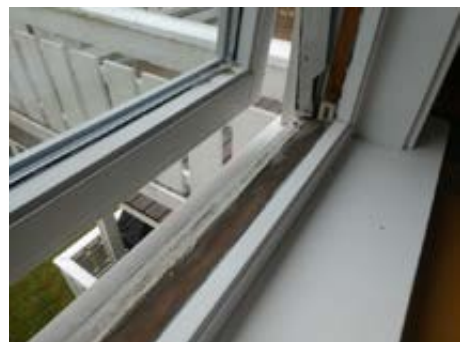
Slitt karm på de eldste vinduene
