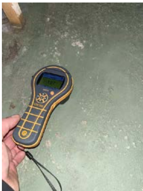
Noe forhøyede fuktverdier i kjellergulv
