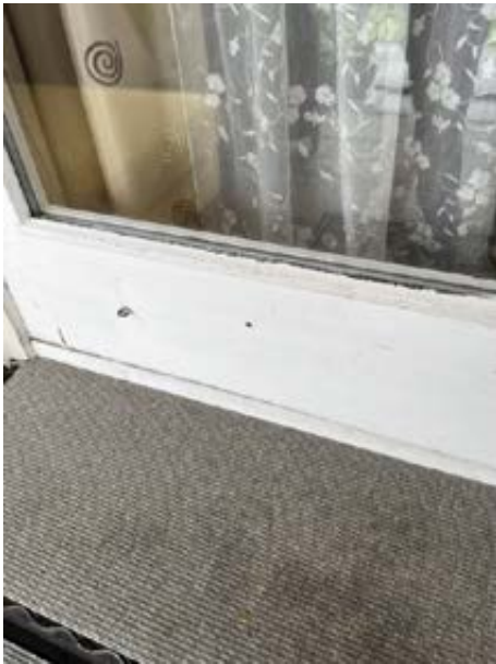
Terrassedør har endel slittasje
