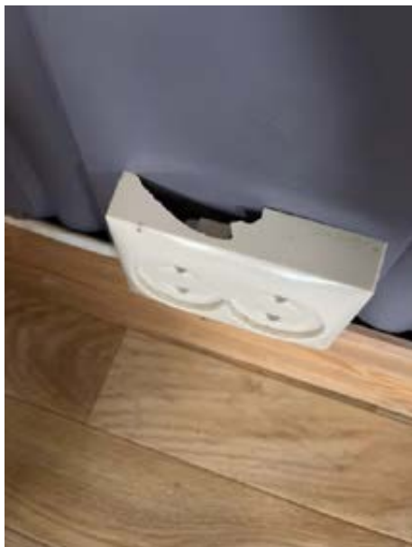
Sprekk i kontakt
