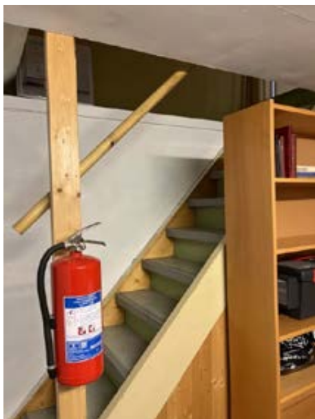
Manglende rekkverk. Nevnte forhold gis tilstandsgrad 3
