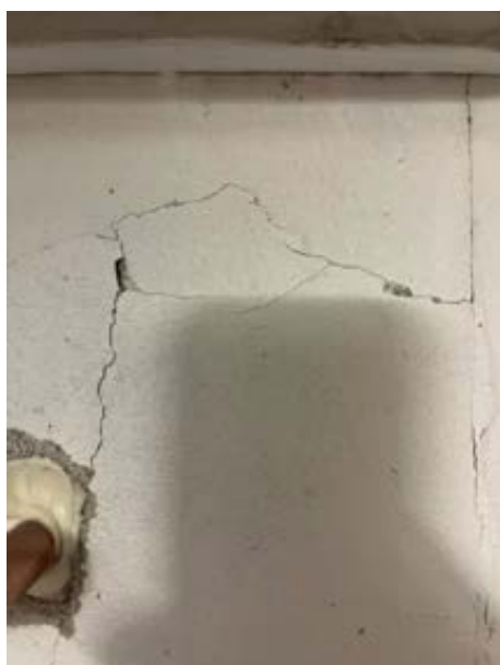
Mindre riss/sprekker registrert i grunnmur
