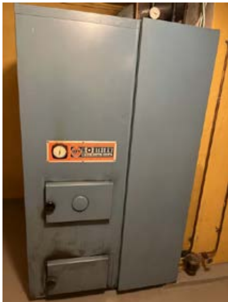
Eldre varmekjele. Eier opplyser om at det kan fyres med både ved og strøm
