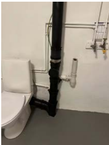
Stakeluke på avløpsrør i plast
