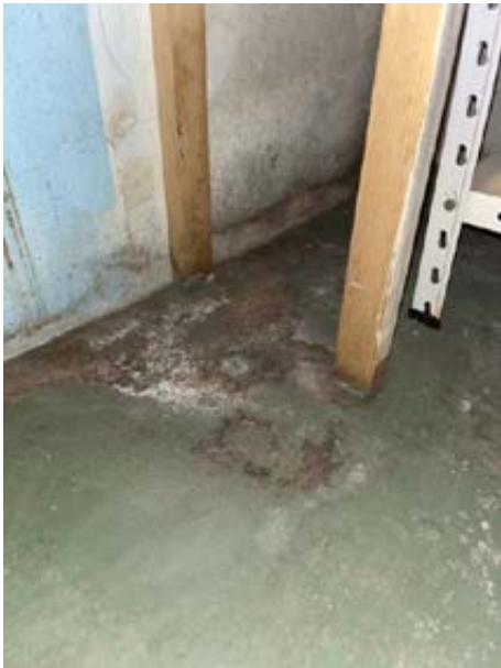
Fuktmerker og saltutslag enkelte steder i kjeller
