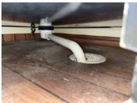
Sluk lokalisert under dusjkabinett
