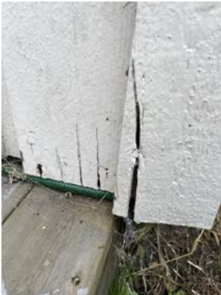
Råteskade registrert i kledning flere steder
