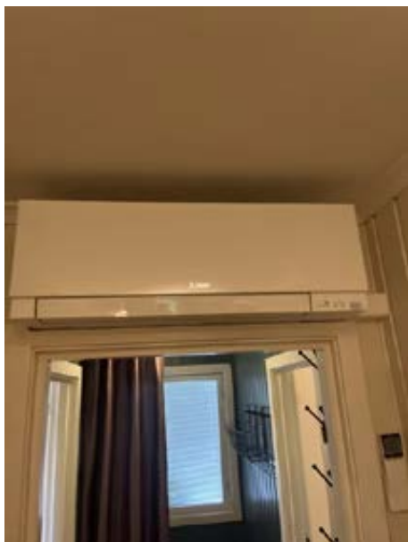
Varmepumpe i soveromsgdel
