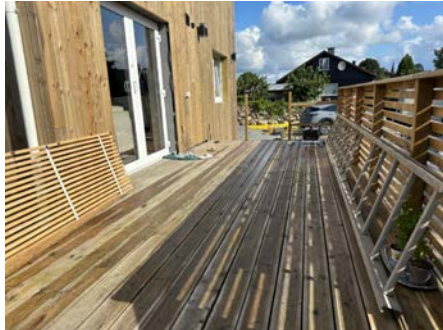
Der er ikke montert rekkverk på terrasse ut fra 1. etasje
