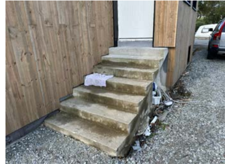
Entrétrapp uten rekkverk
