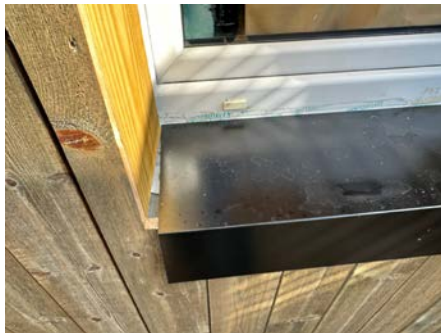
Feil i beslag under vindu
