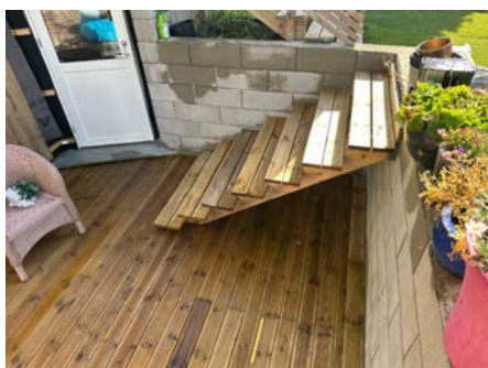
Terrassertrapp uten rekkverk.
