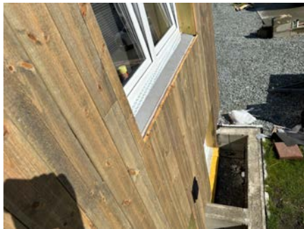
Manglende beslag under vindu
