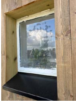
Gamle vinduer i trappegang med enkelt glass.
