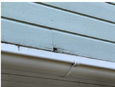
Tegn til råte på kledningen ved inngangspartiet.
