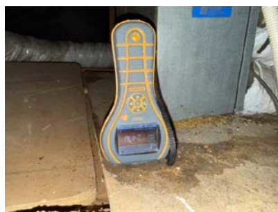
Målinger på gulvplater under åpning i undertaket. Resultat på 24,9 vektprosent.
