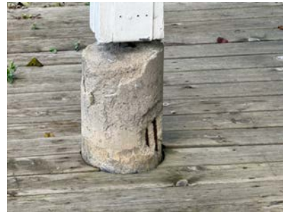
Avskallinger og eksponert armering - søylefundamenter under veranda og takkonstruksjonen.
