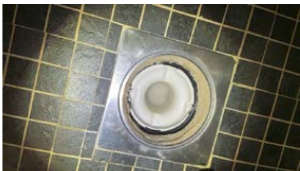
Sluk på bad
