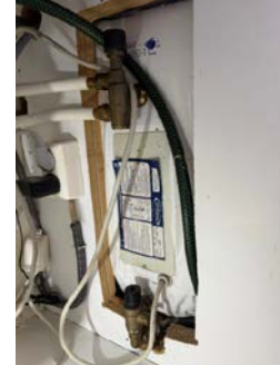
Varmtvannstanken er på ca. 120 liter i kjøkkenbenk fra 2000.
