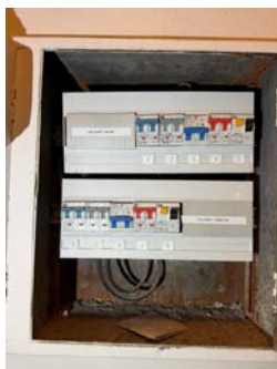
Elskap 1, plassert i felles trappegang.
