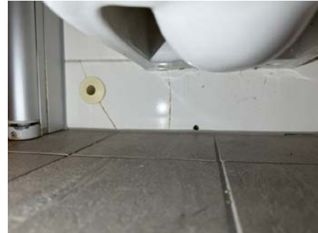
Sprekk i en veggflis under wc.
