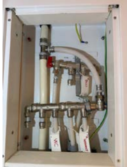
Rørskap på baderomsvegg med stoppekran.
