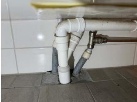
Røropplegg underi servantskap
