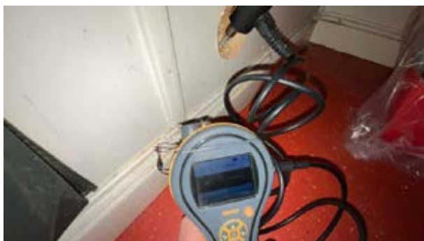
Måling med pigg viste under 7 vekt% ved dagens befarings.
