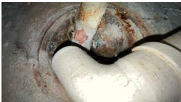
Støpejernssluk under skyllekar.
