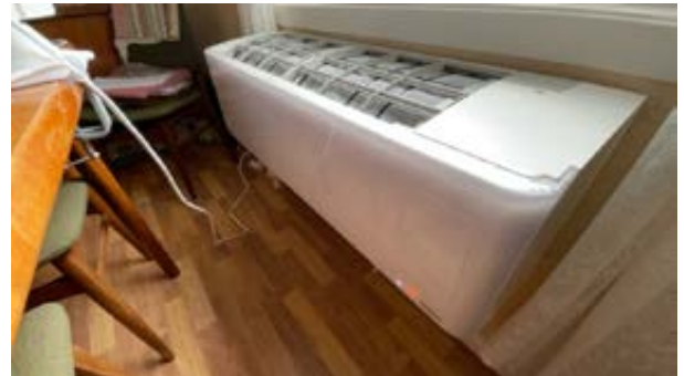
Luft til luft varmepumpe i stue 1. Etasje.
