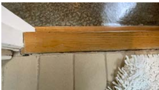
Sprekker ved dørrterskel.
