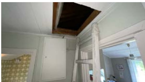
Begrenset tilkomst ved løs stige, inspeksjon er derfor kun utført fra uisolert loftsluke på grunn av egen sikkerhet.
