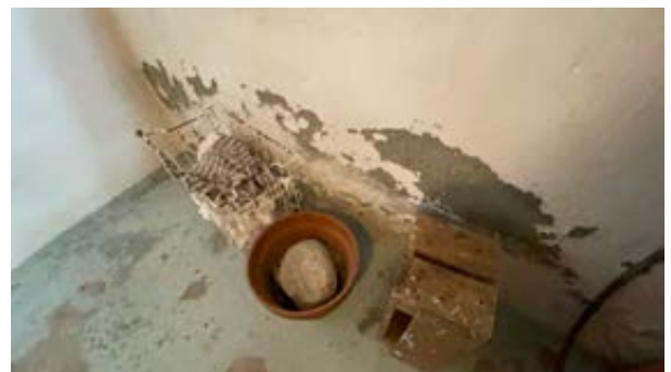
Maling/overflatebehandling er løsnet grunnet fuktvandring ved kalk/saltutslag på yttervegg mot grunn.
