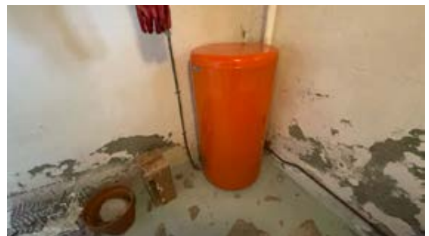
Varmtvannsbreder i vaskerom kjeller.
