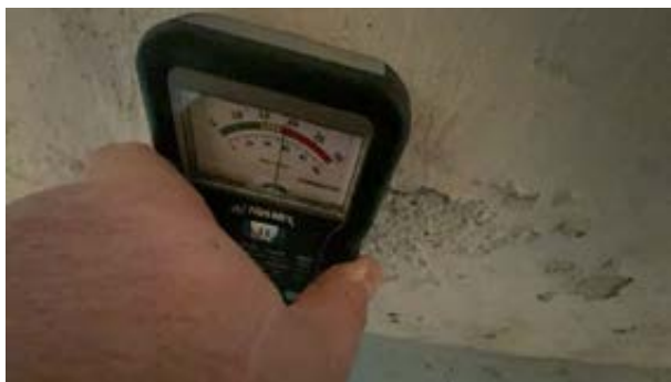
Høyt utslag ved bruk av fuktindikator på vegg.
