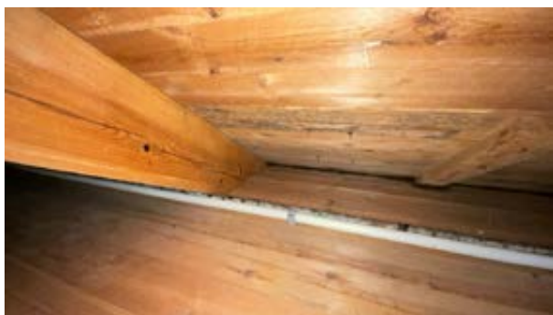
Svak/manglende lufting ved raft. Ventil i gavlvegg i henhold til eier.
