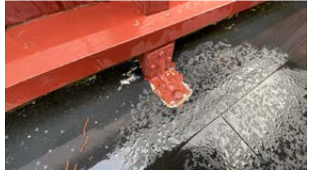
Uheldig innfestning som punkterer tettesjiktet mot underliggende boligrom
