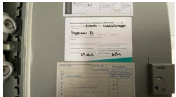
Sikringskap.Samsvarserklæring AMS måler
