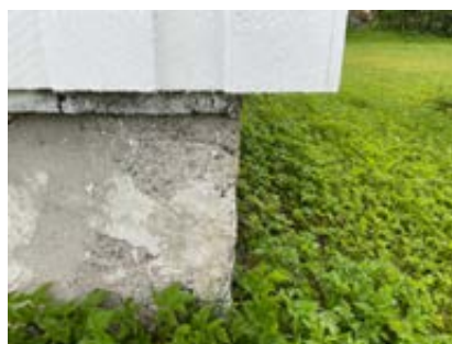
Yttervegg mot sør er plassert skjevt på grunnmur. Synlig avvik målt på hjørner
