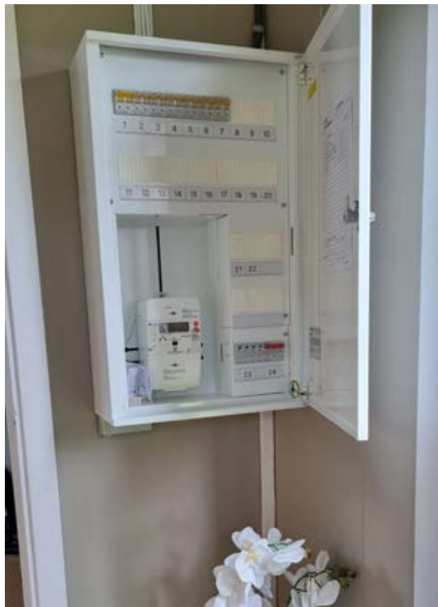
Sikringsskapet står i entreen, automatsikringer. Foto privat
