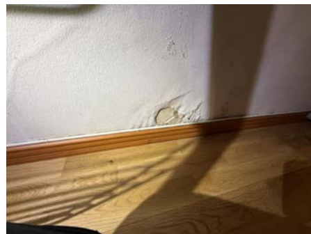
Skader i vegg på soverom.
