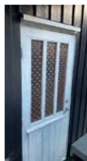
Værslitasje bi-inngangsdør mot bod/aggathus
