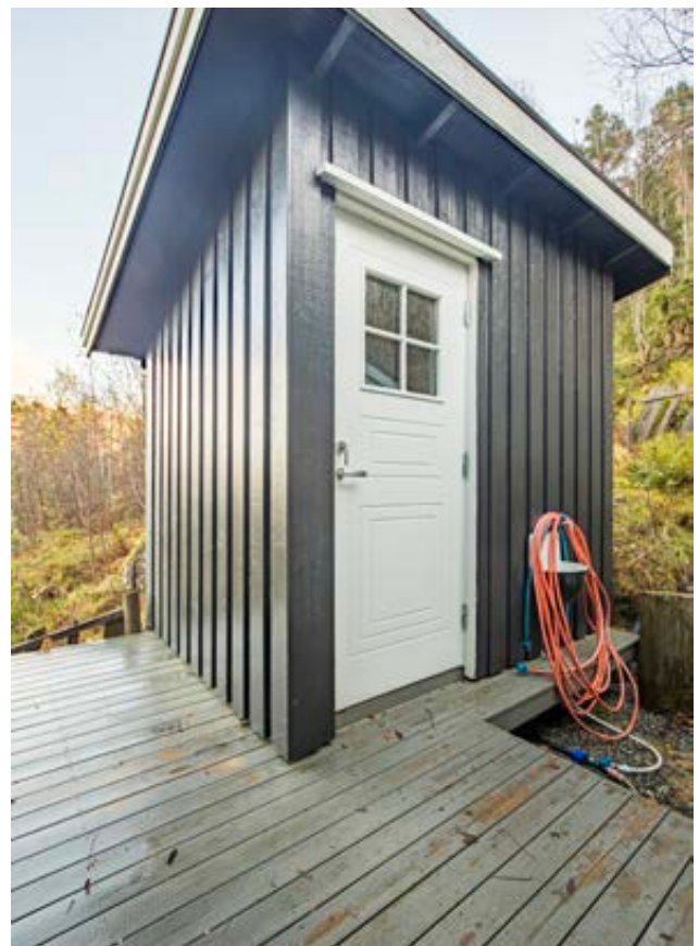
Aggregatthuss med trykkvannspumpe og bodareal
