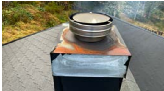
Pipekledning/pipehatt, avflassing og korrosjon
