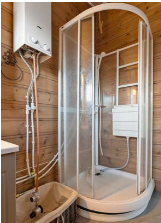
Baderom med gassfyrte varmtvann
