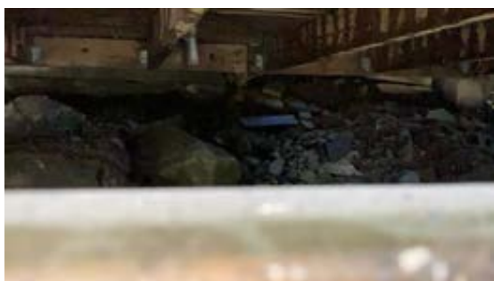
Noe tegn til undergraving grunnmur hjørne ved inngang, nedløp avslutta like ved
