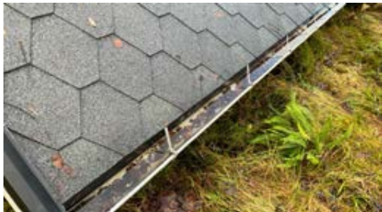
Takrenne står med vann
