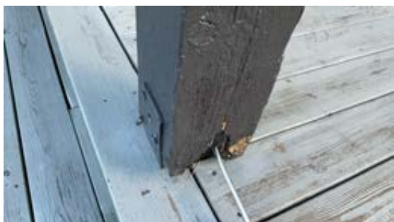
Fukt/råte i nedre del av stolpe v/overbygd inngang
