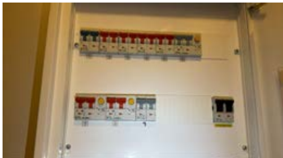
El-skap med automatsikringer
