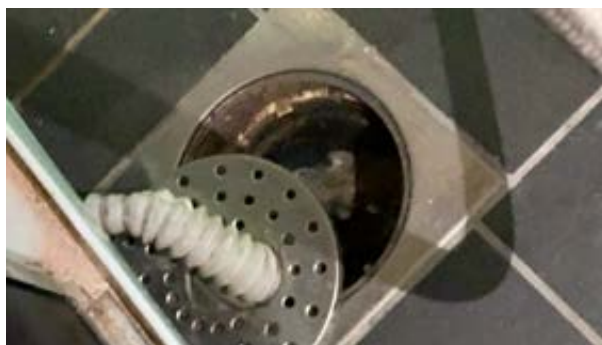
Sluk under dusjkabinett
