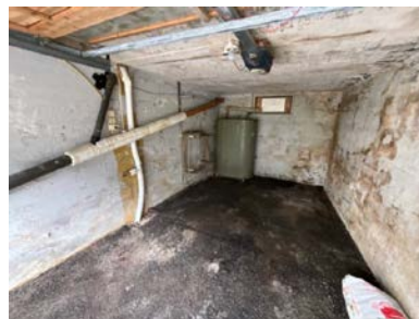
Overflatene inne i garasjen er slitt.
