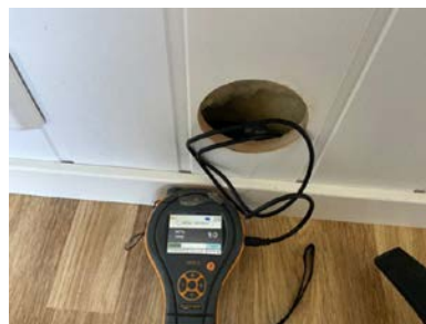
Fuktmåling mot bad i 3. etasje.
