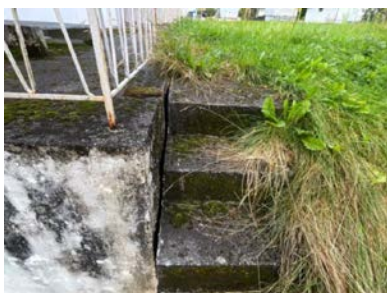
Avstanden mellom trappen og støpt platting mot vest må følges med på over tid.
