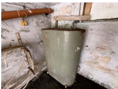
Oljetank er plassert i garasjen.
