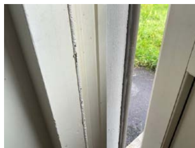
Skade på pakning på terrassedør mot vest.
