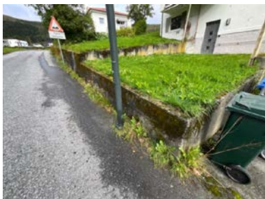
Det mangler rekkverk.
