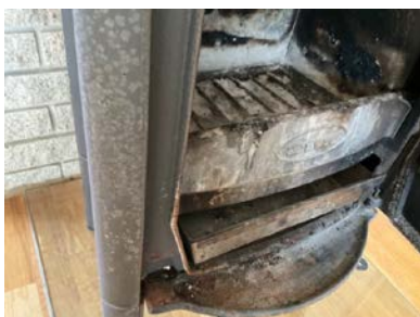
Det er rustflekker på og i ildstedet.
