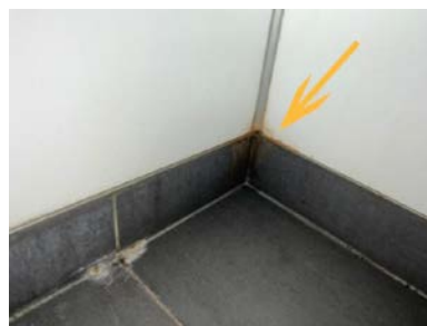
Mindre skade i nedre del av plate i dusjsone.
