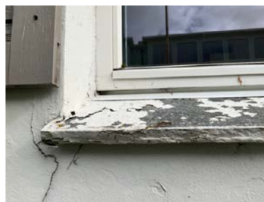
Maling flasser på vannbrett.
