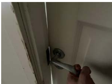
Dører mot bod i 2. etasje subber mot karm. Bildet er fra bod mot øst.
