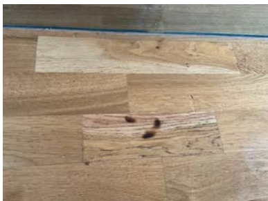
Svimerker på gulvet i 3. etasje.
