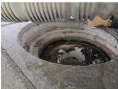
Sluk under dusjkabinett.
