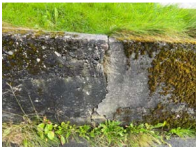
Sprekk i forstøtningsmur.
