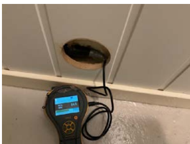
Fuktmåling på vaskerom.
