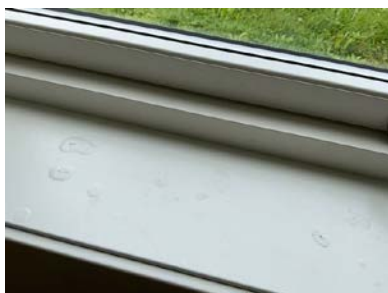
Enkelte vinduer har foringer som er posnet opp innvendig.
