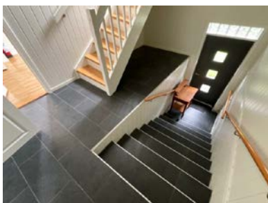
Trappen mangler håndløper og det er ikke montert returgelender.
