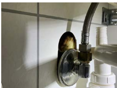
Utett rundt rørgjennomføring under vasken.
