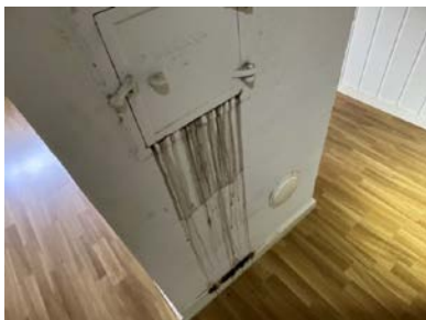
Rennemerke fra feieluke på loftet.
