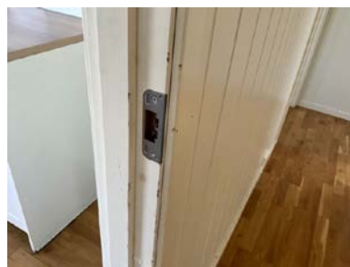
Mindre skade på dør inn mot kjøkken i 3. etasje.
