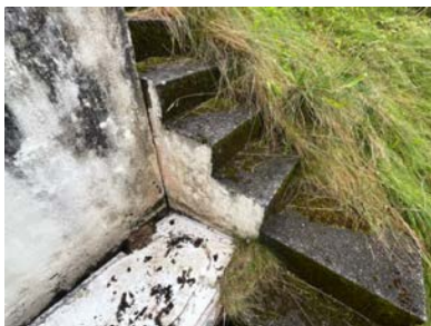
Trappen mot vest mangler rekkverk.
