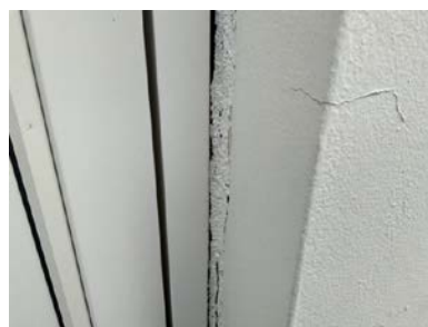
Mot øst er det utett mellom terrassedøren og vegg.
