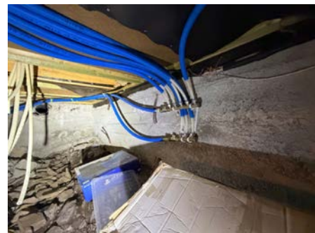
Rør-i-rør med åpen fordelerstokk i kryprom.
