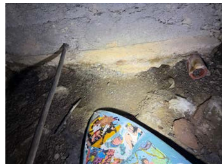
I det minste kryprommet lengst øst er noe vann i grunnen, lite omfang.
