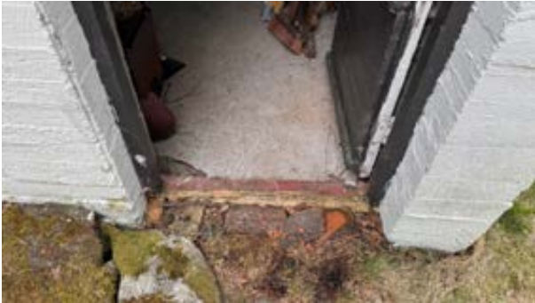
Kjellerdør bla. med defekter i terskel.
