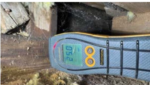
25 vekt% i bunnsvill som støter mot krypkjeller. Måling foretatt over plassering av varmtvannsbereder.
