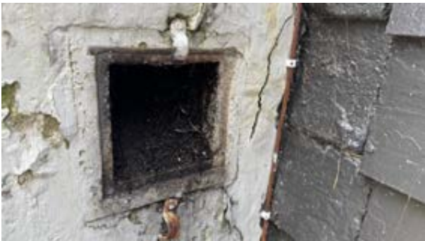
Treverk for nær feieluke, feieluke mangler.
