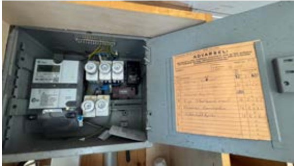
Sikringskap med skrusikringer.
