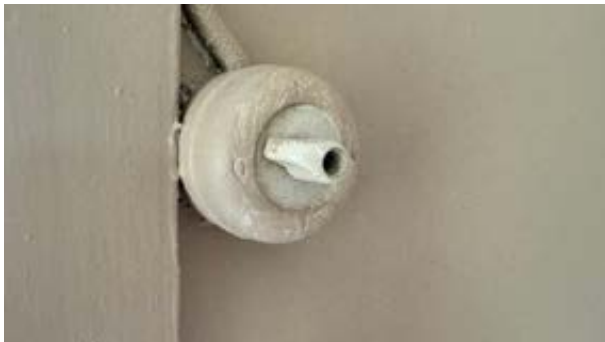
Eldre bryter med kabel fra 50 tallet.
