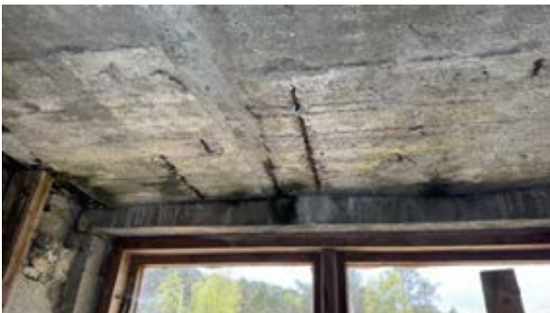
Armeringsrust under støpt balkong.
