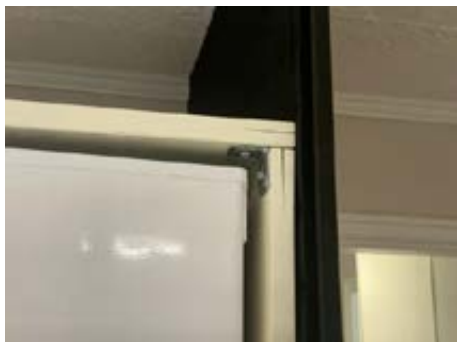
Sprekker på seksjon til kjøleskap.
