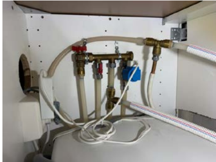
Rør samlestokk i kjøkkenhjørne med stoppekraner.
