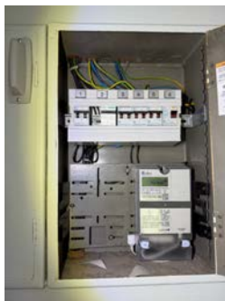
Elskap, plassert i felles trappegang.
