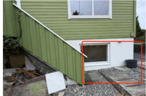
Bildet viser område med påvist fuktighet i tilbakefylte vegger. Se punktet "Rom under terreng".
