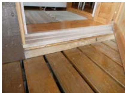
Beslag under balkongdør er ikke etablert.
