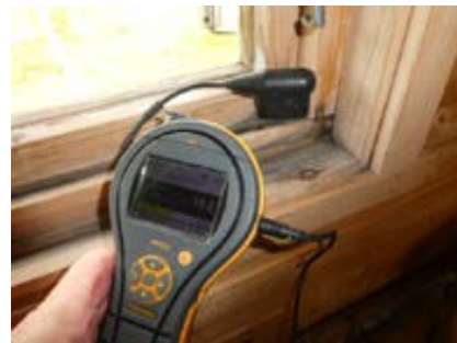
Enkelte vindu er fuktskade
