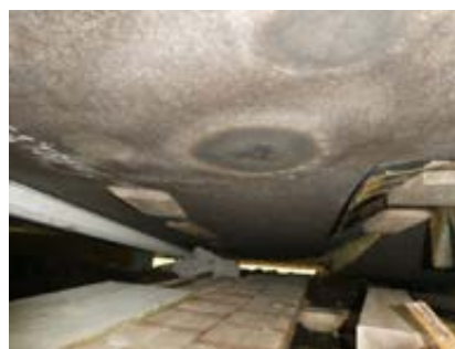
Stubbeloft under tilbygg soverom. Løse stubbelofts plater og tydelig tegn på mus/skadedyr.
