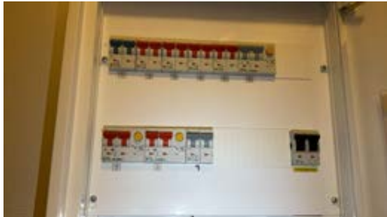
El-skap med automatsikringer
