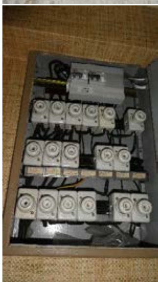
Elskap. Fordeling med skrusikringer.
