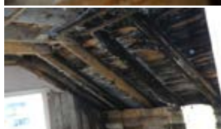
Tresperretak med sperrer og taktro. Råteskade
