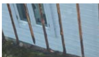
Rekkverk (rustskader) altan 2.etg.
