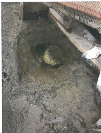
sluk i gulv
