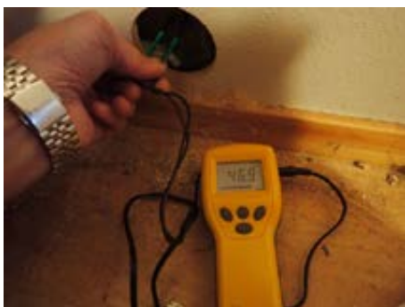
Fuktmåling i utforet vegg mot betongveggen mot vest. 46,9 %
