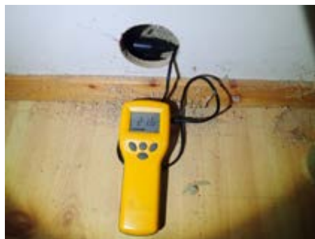
Fuktmåling i svill mot nord. 21,6 %
