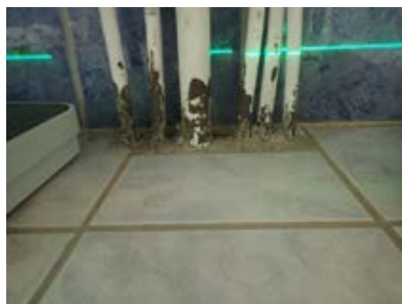
Mangelfull tettinger rundt rørgjennomføringer i gulv.
