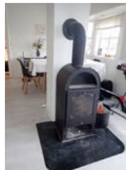
Ovn for fast brensel montert på stålplate.
