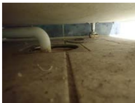
Sluk under dusjkabinett
