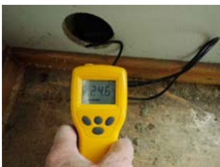
Fuktmåling i svill mot vest. 24,6 %
