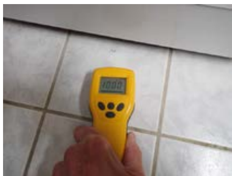
Fuktindikering i gulv v/dusjkabinett
