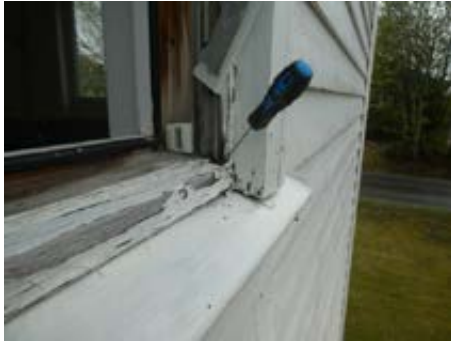
Slitt karm og omramming på de eldste vinduene
