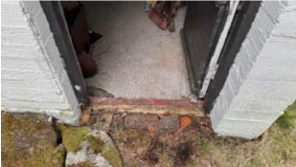
Kjellerdør bla. med defekter i terskel.
