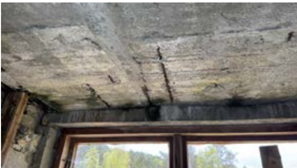
Armeringsrust under støpt balkong.
