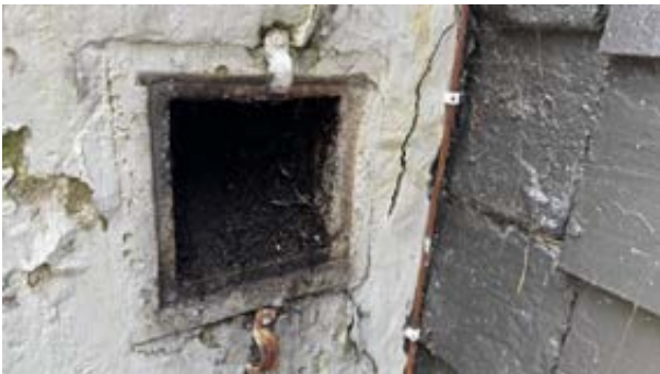
Treverk for nær feieluke, feieluke mangler.
