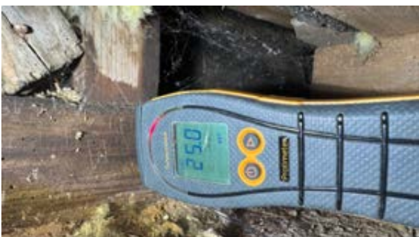
25 vekt% i bunnsvill som støter mot krypkjeller. Måling foretatt over plassering av varmtvannsbereder.
