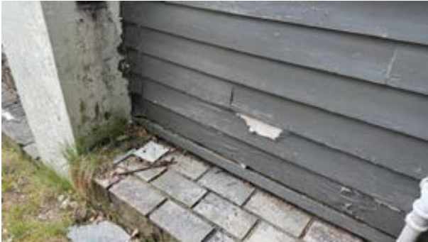
En del råte ved pipestokk.
