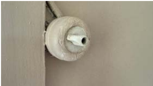
Eldre bryter med kabel fra 50 tallet.
