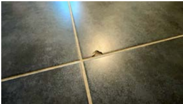
Skade i en gulvflis.
