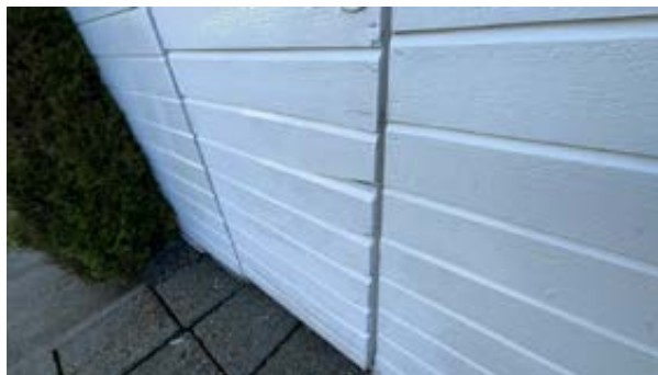
Skade på dør i levegg.
