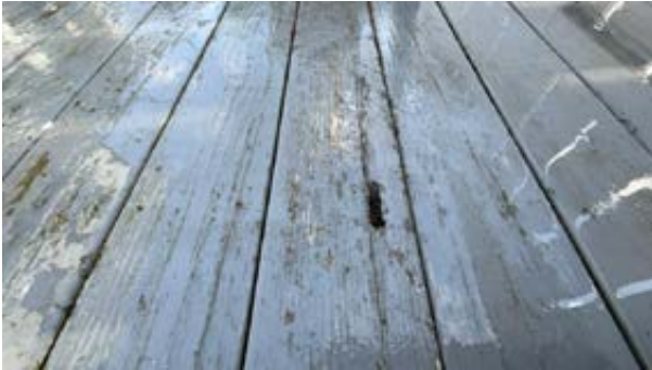
Råteskade på terrassebord.
