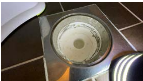
Sluk ved baderomsinnredning.
