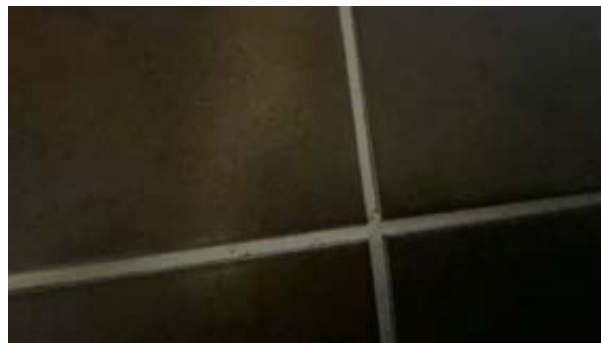
Grunne flisfuger og noen riss.
