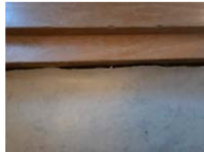
Utett belegg på gulv.
