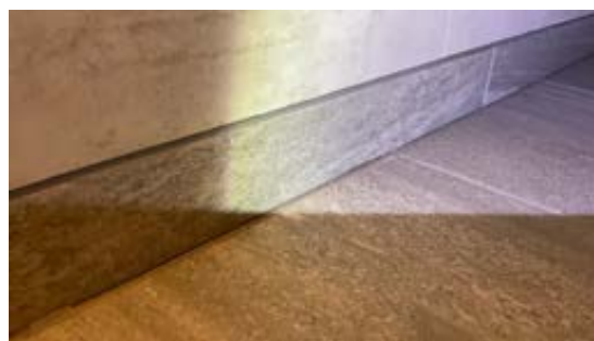
Glippe fuge mellom gulv og sokkelflis
