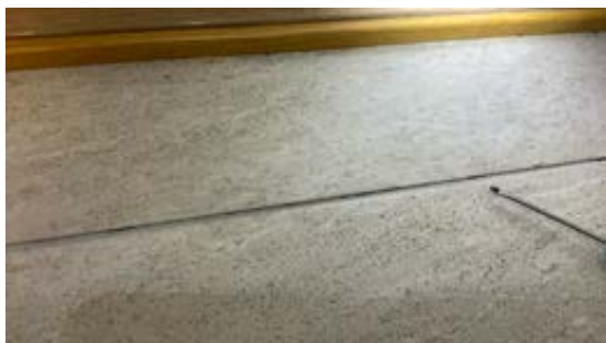
Riss, bomlyd, flis ved dør til altan
