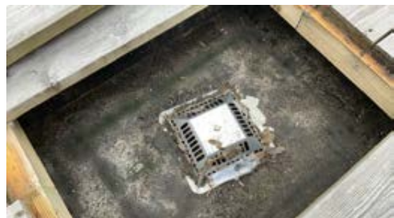
Sluk(nedsenka renne), i følge rekvirent er det overløp sør.
