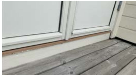
Ikke beslag under dører andre etasje
