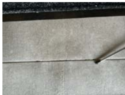
Flis ved ytterdør, sprukket fuge
