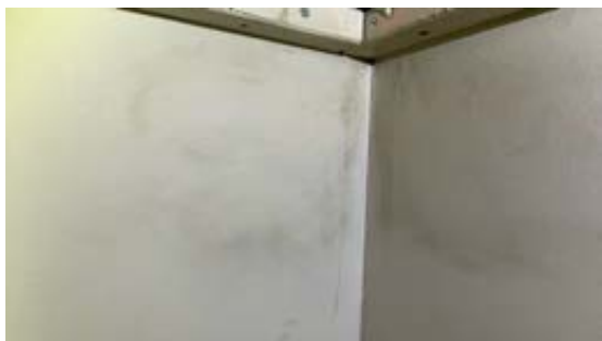
Misfarging under kontorpult første etasje
