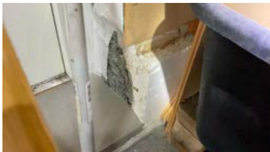
Synlig brennbar isolasjon
