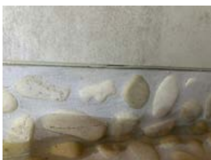
Glippe i fuge mellom bunnprofil og baderomsplate
