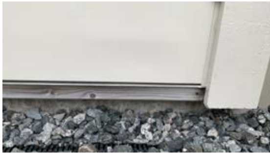
Beslag ikke montert, dør ved garasje/sportsbod
