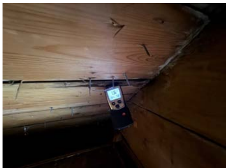
13,6 vektprosent i fuktskjolder, ikke utslag på fukt.
