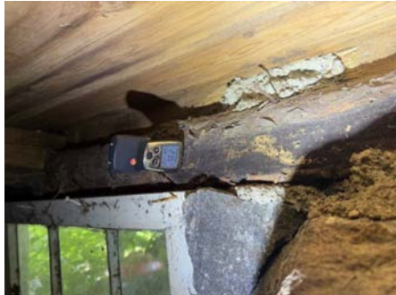
Råte i bjelke mot grunnmur. 23,5 vektprosent.
