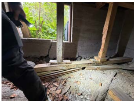
Deler av understøtting henger i luften.
