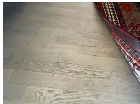
Oppsprukket gulvoverflater spesielt i stuen.
