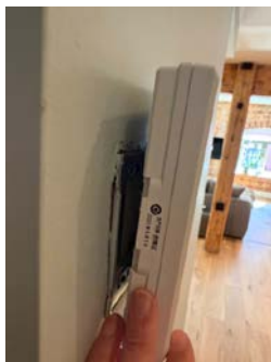
Det bemerkes løst callinganlegg ved inngang/kjøkken.
