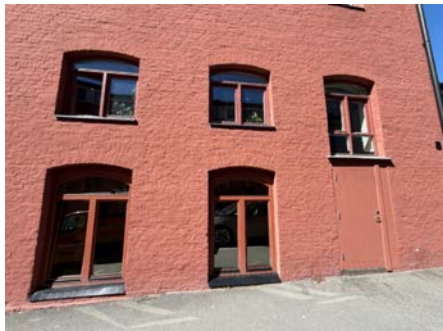
Dugg i et vindusglass i stue
