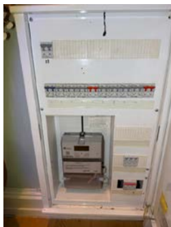
Automatsikringer med skap i stue v/trapp.
