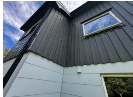
Værslitt og oppsprukket bordkledning.
