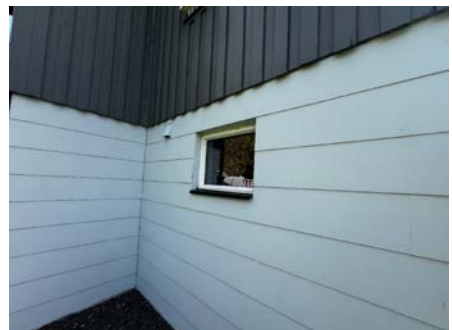
Disse hvite platene på veggene inneholder asbest.
