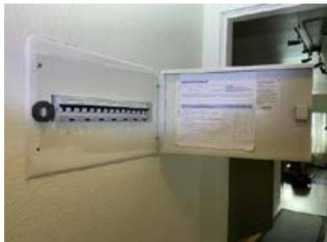
Sikringsskap står i entre.
