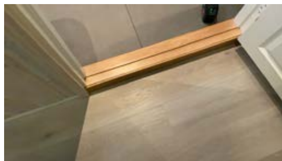
Oppkant ved dør på ca. 20 mm.
