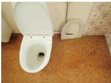
Sete og lokk mangler
