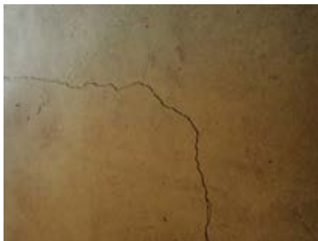
Sprekk i betonggulv
