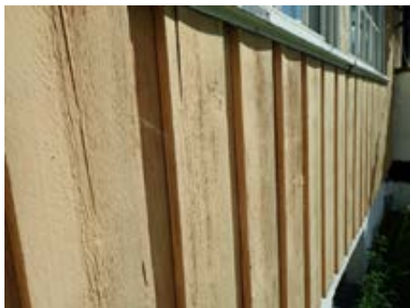
Sprekker i kledningen
