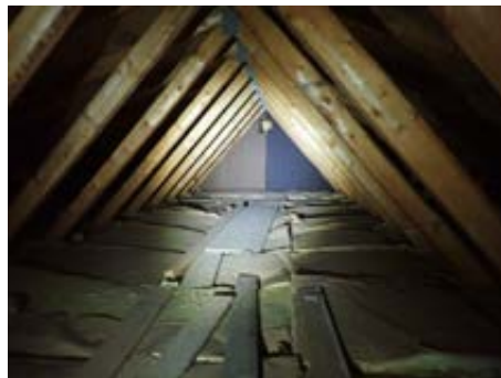
Ventil i røstveggene
