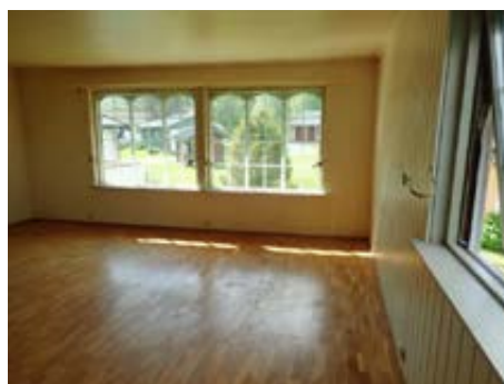
Brune vegger og tak pga. røyking
