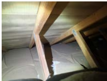
Luftespalte ved raft
