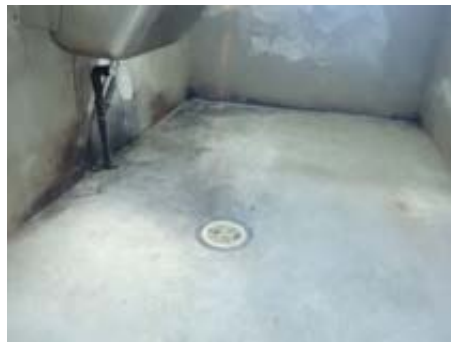
Fukt i overgang gulv/vegger på vaskerom
