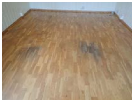
Skader i parketten på stua.
