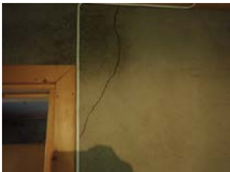
Sprekk i innvendig skillevegg
