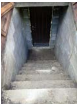
Kjellertrapp med skader i trinnene
