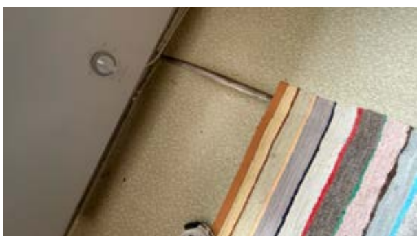
Belegget har gått fra hverandre i en skjøt.
