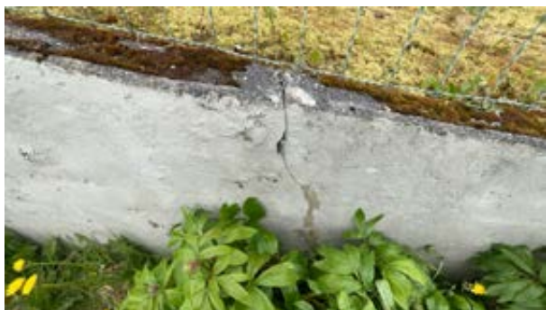
Sprekk i støttemur.
