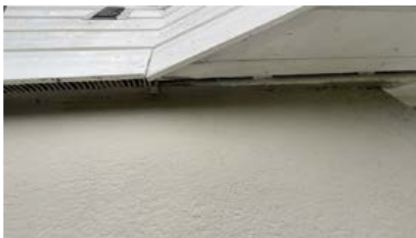
Stedvis manglende musesperre.
