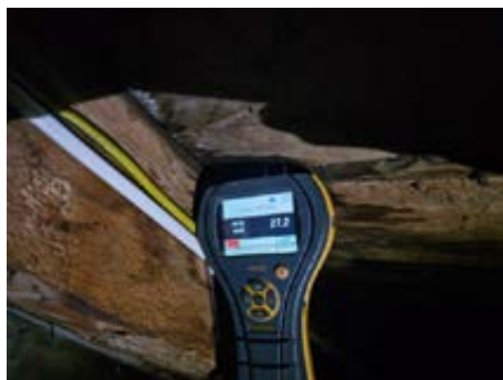
Det er målt fuktighet flere steder.
