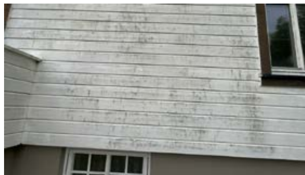
Kledningen fremstår jevnt over som værslitt.
