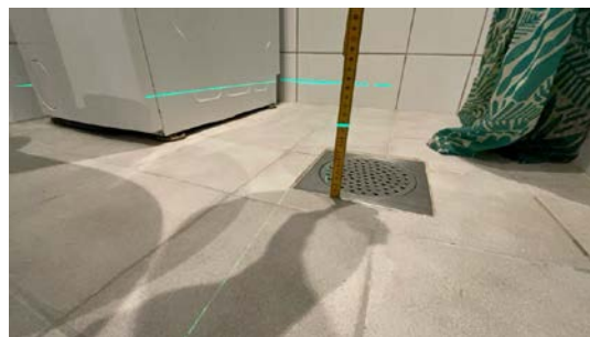
Høydeforskjell (ved sluk)
