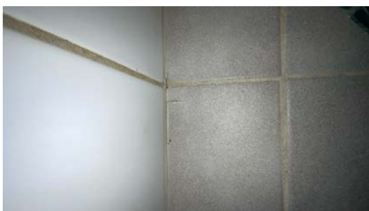
Sprekk i flis
