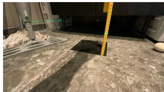
Høydeforskjell (ved sluk)
