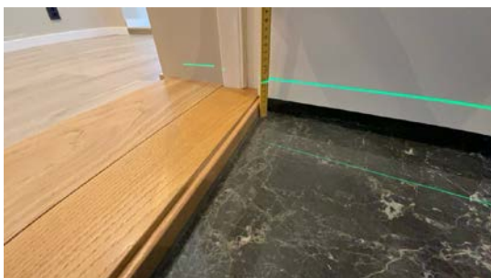
Høydeforskjell (flis ved terskel)
