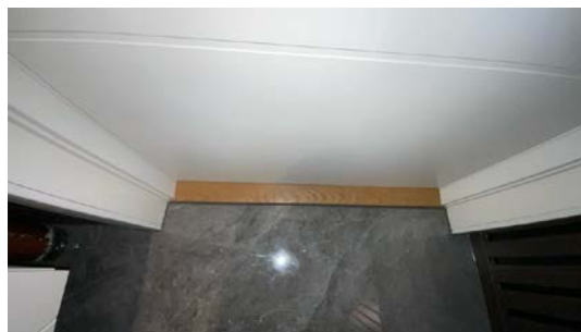
Ingen spalte for tilluft
