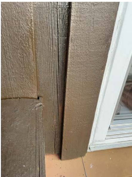
Sprekker i noen klednings-bord.
