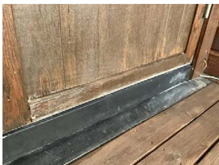
Fukt/råte på terrassedør til balkong 2 etasje. Bytte av dør må påregnes i tiden som kom kommer. Tetting er usikker.
