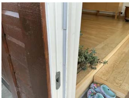
Skade på pakning til skyvedør. Trekk fra dør må påregnes.
