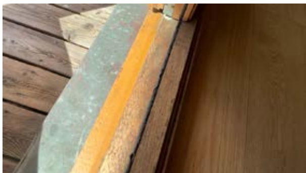
Skadet pakning på terrassedøren.
