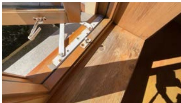
Fuktskjolder i vindusforing. Det er også fuktskjolder på vinduskarmen.
