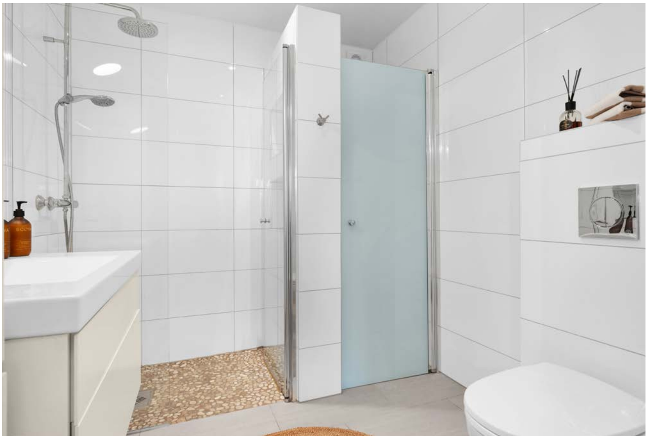
Bad - helfliset med varmekabler
