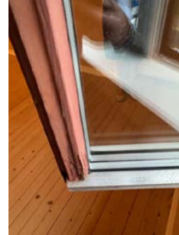
Utvendige vinduskarmer med sprekker i trevirket.
