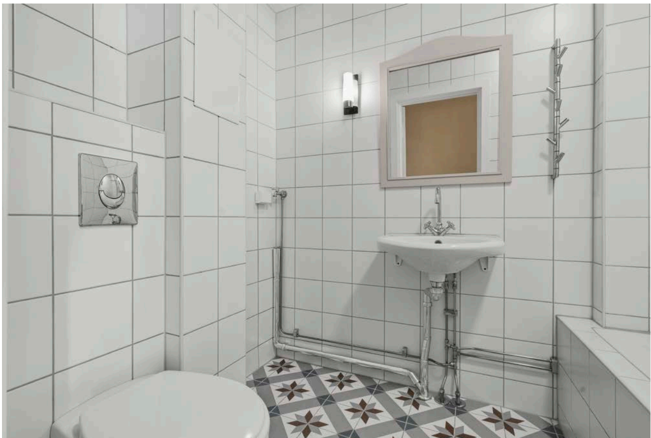
Ventilasjonen er naturlig oppdriftsventilasjon med avtrekksventil i himling og tilluft via dørterskel. Badet er ble rehabilitert borettslagets regi i 2013.
