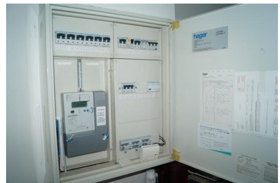
Automater i sikringskap
