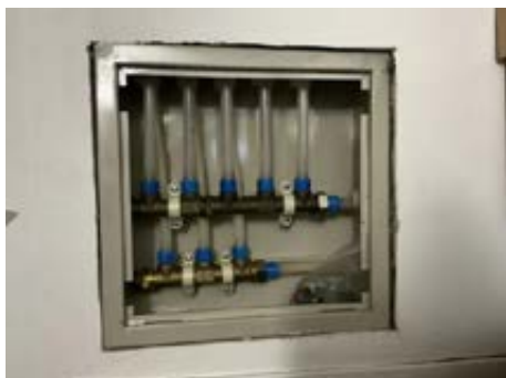
Rør-fordeling er ikke merket. Sprut-deksel er ikke montert.
