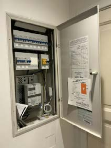
Sikringsskap står i gang.
