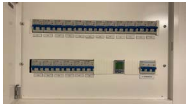
El-skap med automatsikringer
