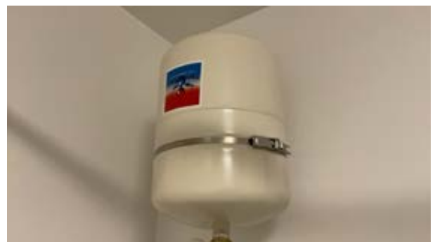
NB ! Ekspansjonstanker bør ha jevnlig service.
