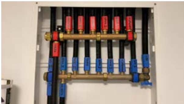
Fordelerskap med rør i rør opplegg
