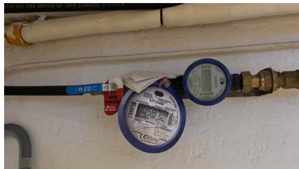
Stoppekran i kjeller
